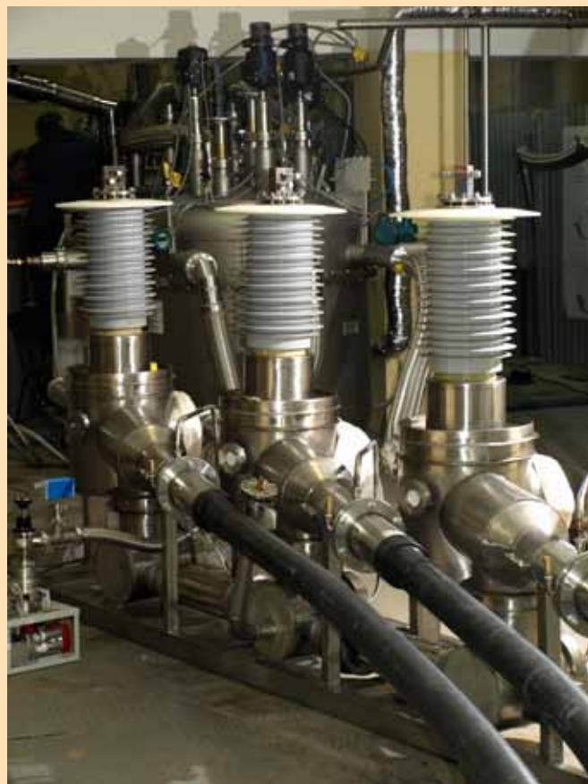
Рис. 6. ВТСП кабельная линия на испытательном полигоне
